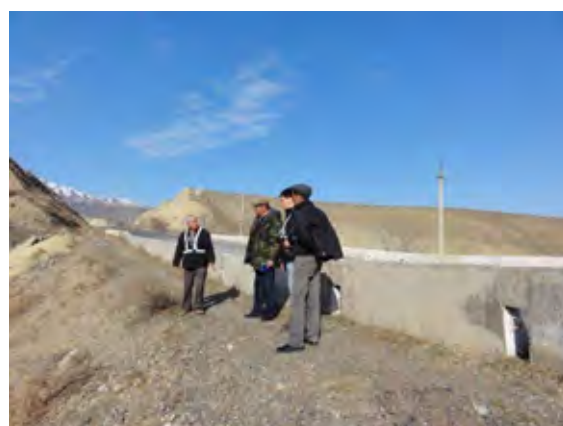
331K+300 付近 路面沈下箇所調査状況
