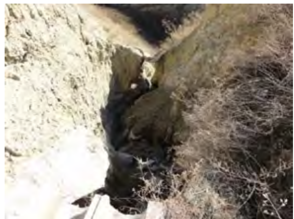
303K+300 付近 縦排水路の洗掘・破損
