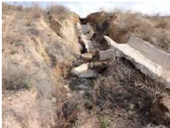
292K+100 付近 縦排水路の洗掘・破損
