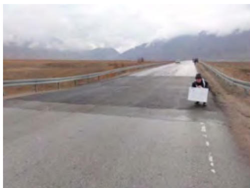
312K+700 付近 路面沈下
