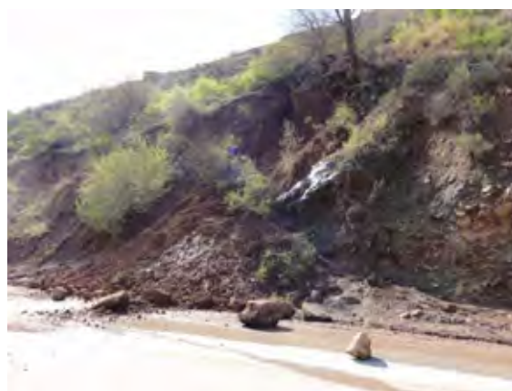
397K+500 付近 切土法面の崩落
