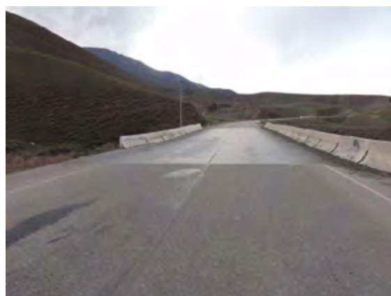
340K+705 付近 路面沈下
