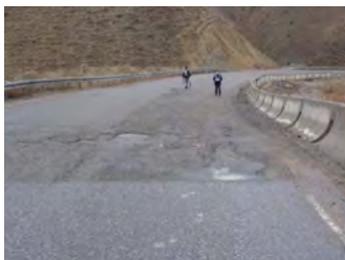
303K+300 付近 路面沈下
