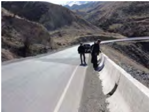
403K+550 付近 路面沈下
