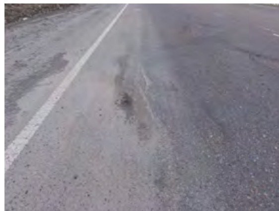
353K+300 付近 舗装の寄り
