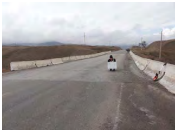
329K+300 付近 路面沈下
