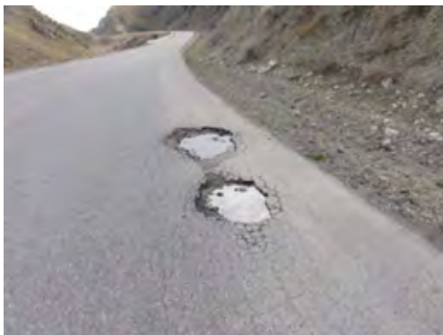
338K+000 付近 ポットホール
