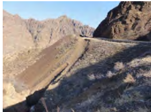
403K+550 付近 法面崩落
