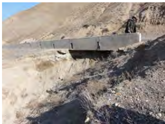
356K+600 付近 盛土法面の崩落
