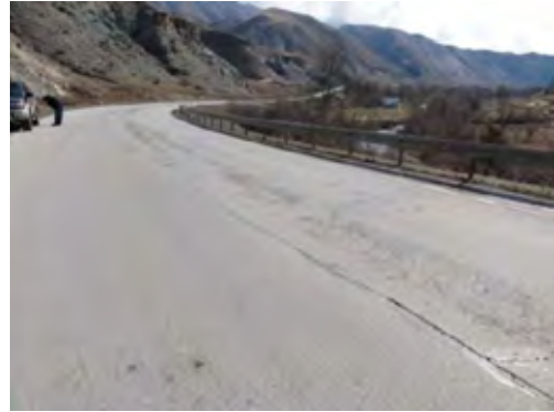
365K+840 付近 路面沈下
