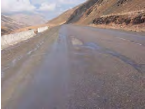
358K+830 付近 路面沈下
