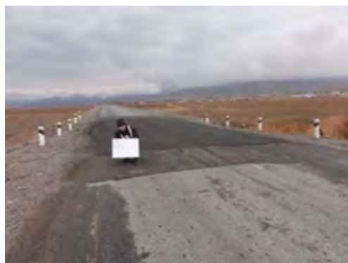
313K+100 付近 路面沈下
