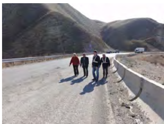
303K+300 付近 路面沈下箇所調査状況
