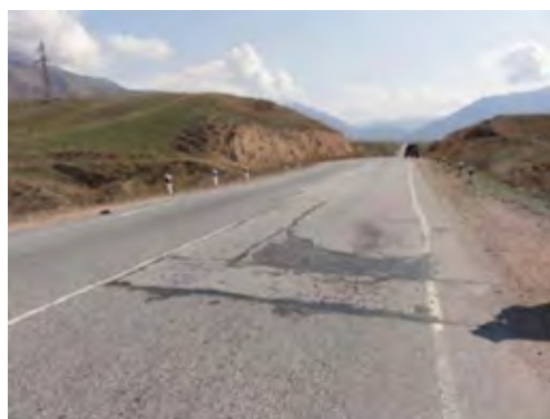
305K+600 付近 路面沈下
