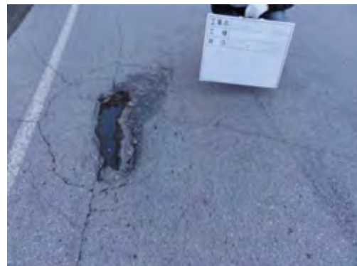
401K+200 付近 ポットホール
