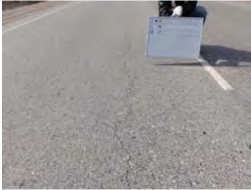
289K+900 付近 線状クラック
