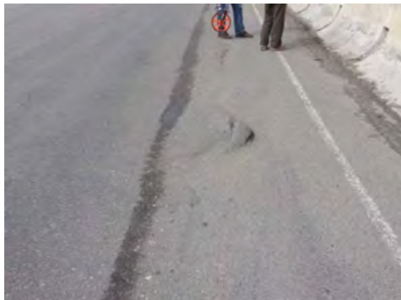
333K+600 付近 舗装の寄り
