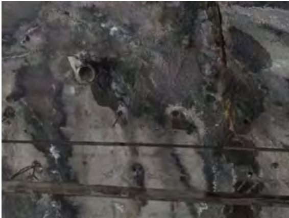
トンネル No.1 漏水状況
