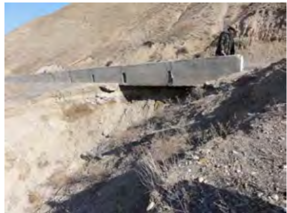
356K+600 付近 盛土法面の崩落
