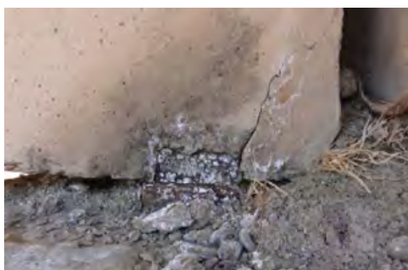
№ 8 Dry stream canal Shilenkana 桁支承上にせん断クラックが発生している
