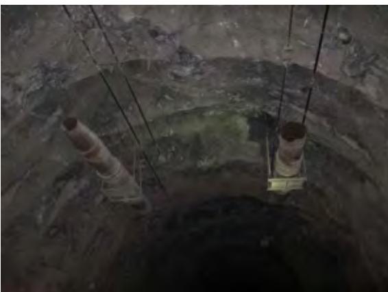
換気設備 (トンネル No.2 のみ)
