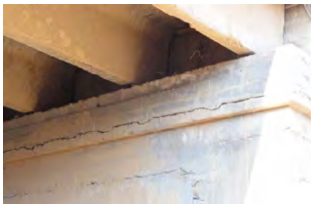
№ 7 Dry stream canal Oital 橋台で水平に広がる大きなクラック
