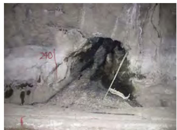
トンネル No.2 右側壁 下部崩落
