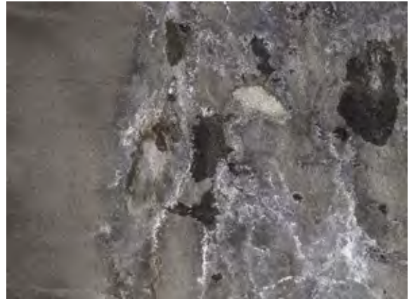
トンネル No.1 はく落状況
