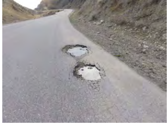
338K+000 付近 ポットホール
