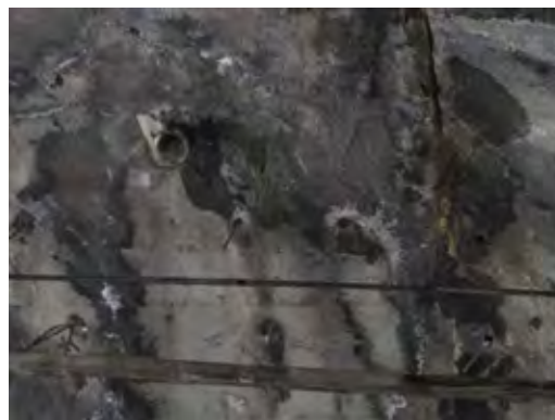
トンネル No.1 漏水箇所
