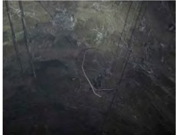
ケーブル類の垂れ下がり
