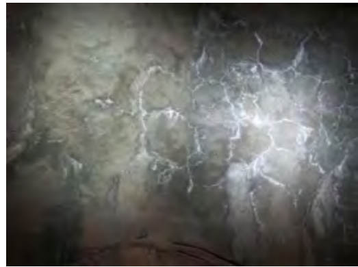
トンネル No. 1 吹付けコンクリート ひび割れ状況 (起点側坑口から 140m 付近)
