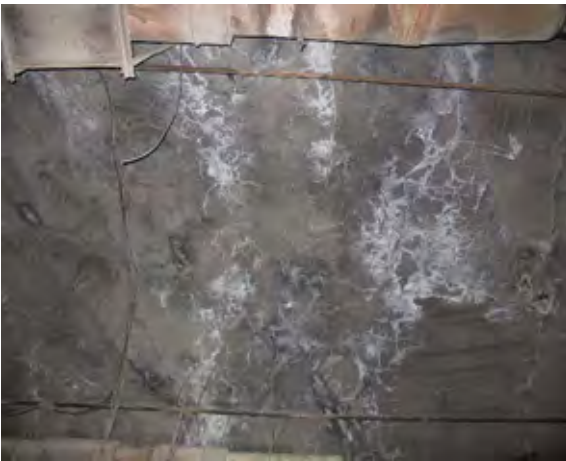
トンネル No.2 ひび割れ状況
