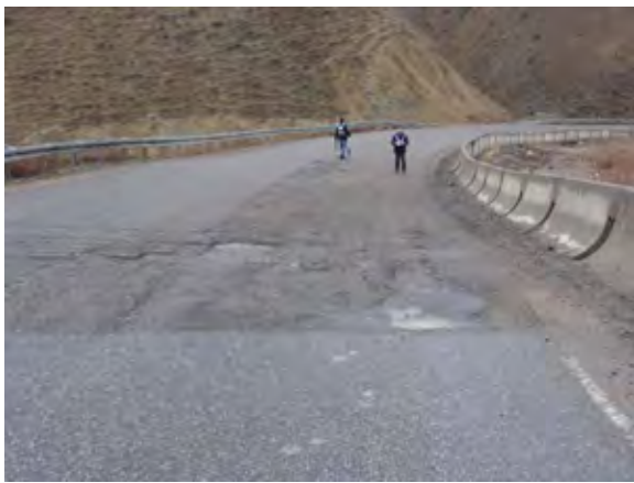
303K+300 付近 路面沈下
