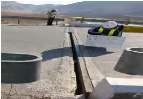
№ 10 ナリン川橋 橋面状況 伸縮装置破損
