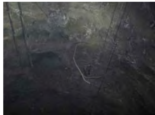
トンネル No. 1 ケーブルの垂れ下がり (起点側坑口から 250m 付近)
