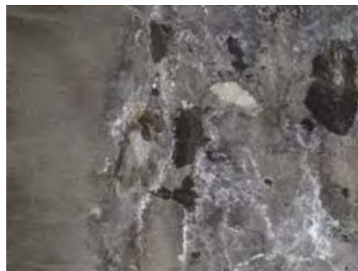
トンネル No.1 吹付けコンクリート剥落状況 (起点側坑口から 290m付近)
