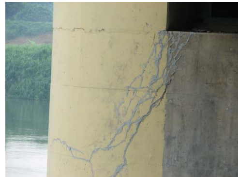
写真 3-3-4 P2 橋脚 ひび割れ状況
