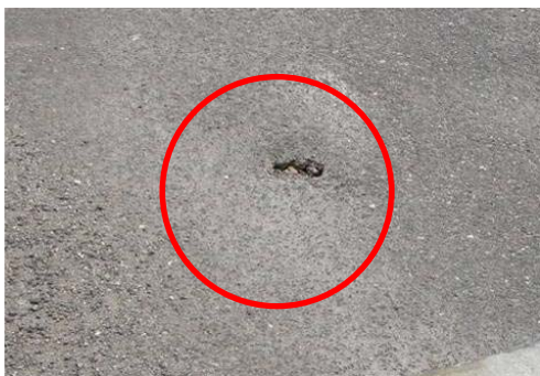
写真 6-2-1 橋面のポットホールト （イラマ橋）
