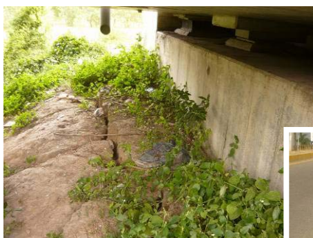
写真 3-8-1 A1 橋台前面の亀裂
