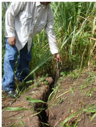
写真 3-8-4 バナナ畑の亀裂
