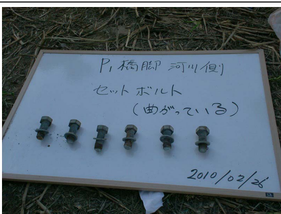
写真-12 調査で判明したセットボルトの抜け落ち(P1 橋脚側)
