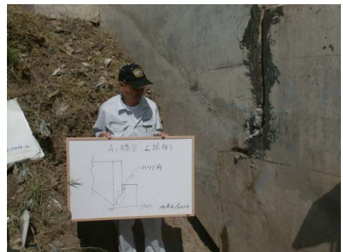
写真 3-3-2 A1 橋台 ひび割れ状況
