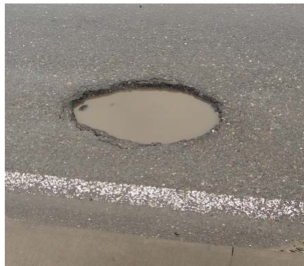
写真 6-1-1 橋面のポットホールト （デモクラシア橋）
