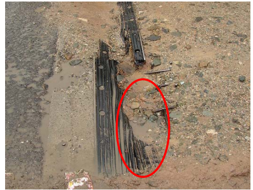
写真 3-3-1 伸縮装置 アンカー鉄筋の露出状況
