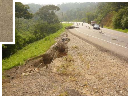
写真 3-8-5 道路のがけ崩れ
