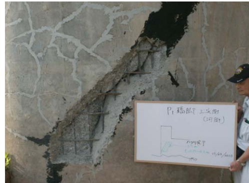
写真 3-3-3 P1 橋脚 ひび割れ状況
