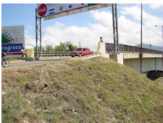
写真-5 橋台と土工部に発生した沈下状況 (デモクラシア新橋サンペドロスーラ市側)
