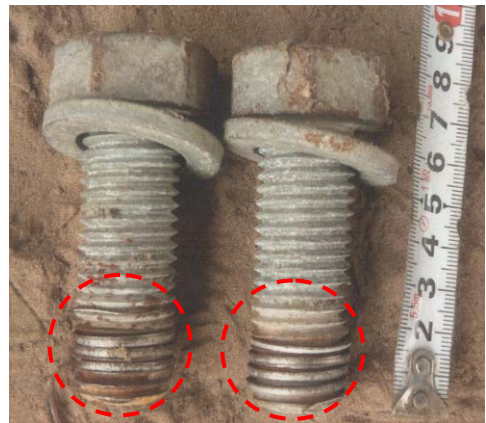
写真 3-5-3 セットボルト損傷状況 (円内ベースプレートへのねじ込み範囲)
