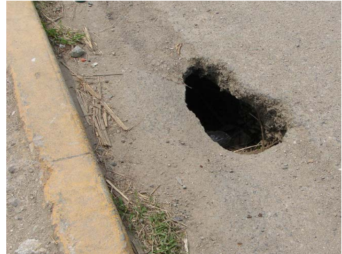
写真 3-4-1 取付道路部の陥没状況
