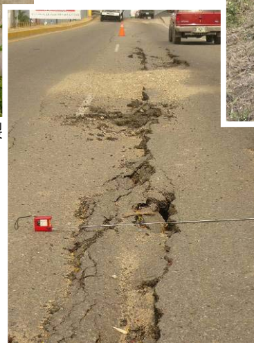
写真 3-8-3 橋梁取付 土工部の路面の亀裂
