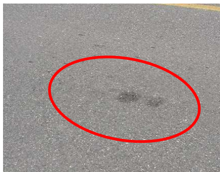
写真 6-2-2 橋面の舗装の摩耗 （イラマ橋 左岸側橋台付近）
