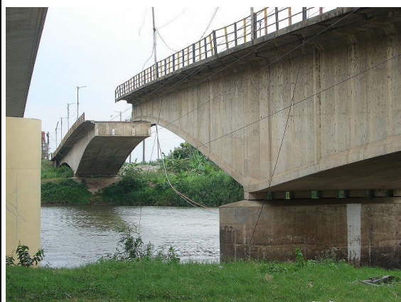
写真-4 落橋したデモクラシア旧橋
