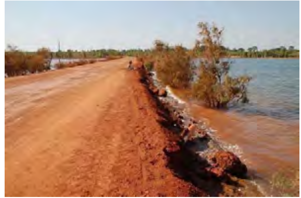
写真 冠水後 道路嵩上げ 2010年11月26日
