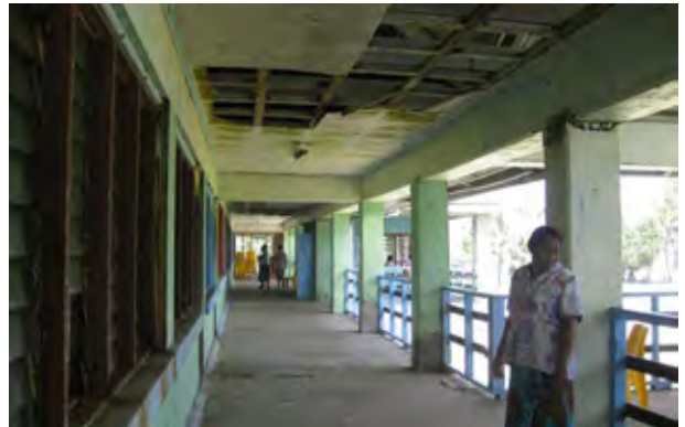
フェツバル中学校。施設は傷みが激しく、適切な環境とはいえない。
