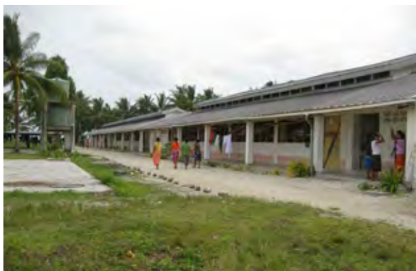
女子寮。トラス間隔が広いため屋根の下りが目立つ。塩ビ製軒樋が設置されているが集水用としては機能していない。
