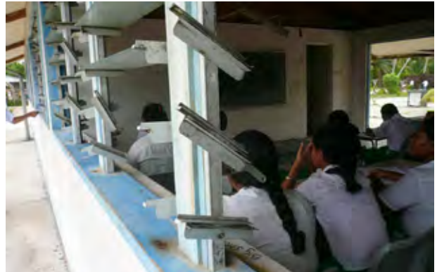
一般教室棟。ルーバー窓のガラスがすべて取れている。アルミ枠の品質に問題あり。
