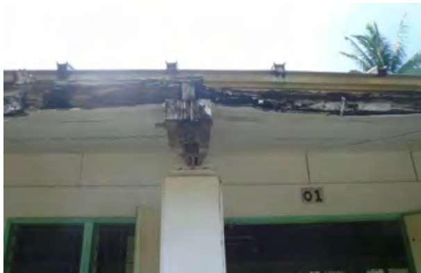
特別教室棟、軒先破損部の詳細。放置すればトラス材・母屋材に腐食が広がる可能性が高い。
