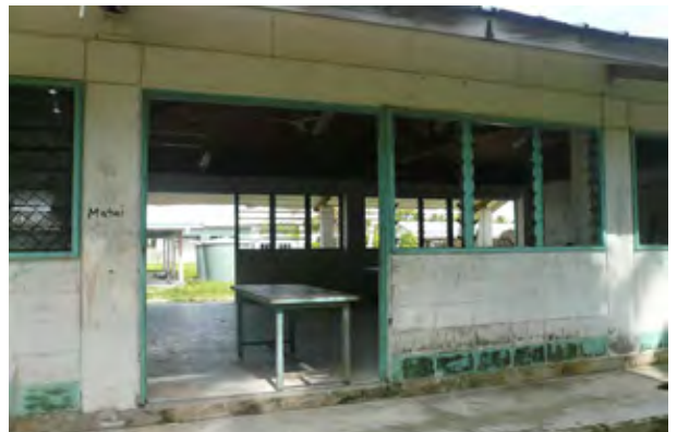
特別教室棟。ドア・窓ガラスがすべて無くなっている。
