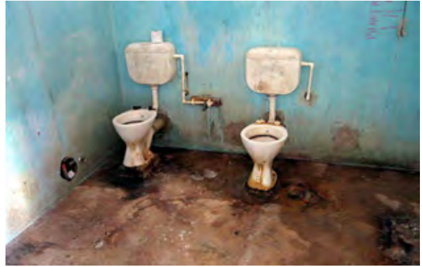
男子寮便所。パーティションはすべて無くなっており、便器も便座が取れた状態である。
