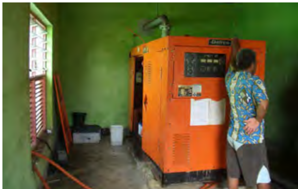
前回無償資金協力により整備された発電機。調査時点では故障中で修理のための部品待ちの状態であった。
