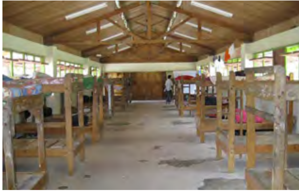
男子寮内部。床材が一部剥離しているが、機能上大きな問題は無い。
