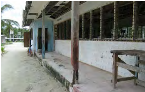
一般・特別教室棟。柱の鉄筋が露出し危険な状態。撤去予定。
