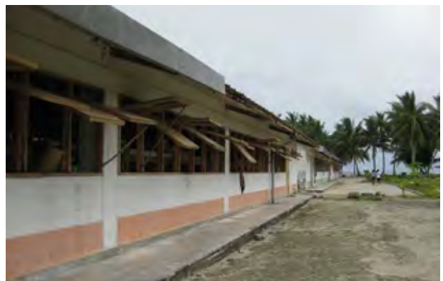
女子寮。ガラスが取れてしまった窓を撤去し、突出し式の板戸が設けられている。
