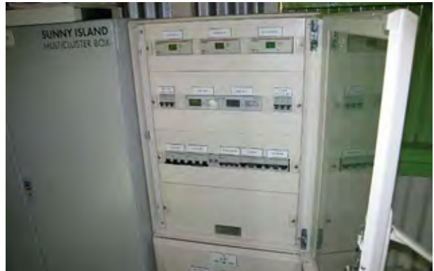
太陽光発電用蓄電池室に設置された主配電盤。3種類の電力を受入れ既存2系統に送電する。
