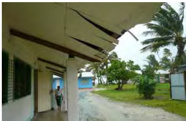
特別教室棟。軒先の損傷が軒天井に拡がっている。
