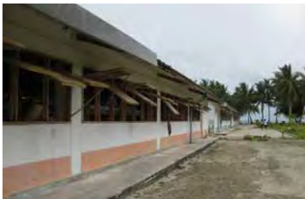
女子寮。ガラスが取れてしまった窓を撤去し、突出し式の板戸が設けられている。
