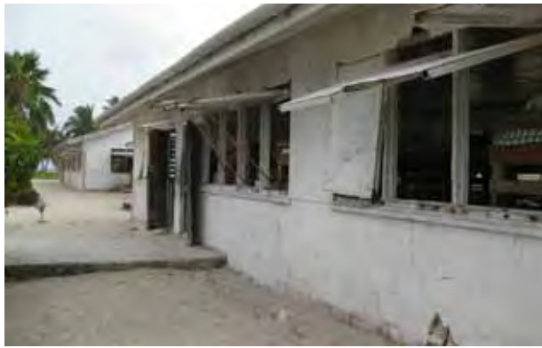
女子寮。ブロックによる組積造だが、壁にクラックが入り、経年劣化が進んでいる。
