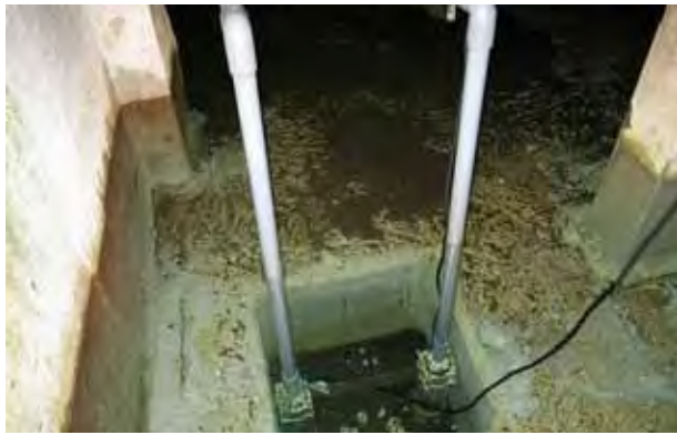
無償資金協力による埋設貯水槽。雨水を集水する樋・配管が損壊しているため、非常時以外は使われていない。
