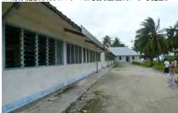
一般教室棟。軒先の樋、幕板が破損している。
