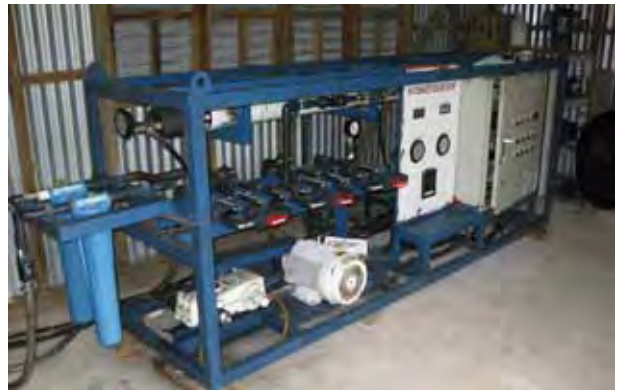
早魃時に最低限の飲用水を確保するため淡水化装置が置かれている。日本の緊急無償で供与されたもの。
