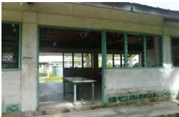
特別教室棟。ドア・窓ガラスがすべて無くなっている。
