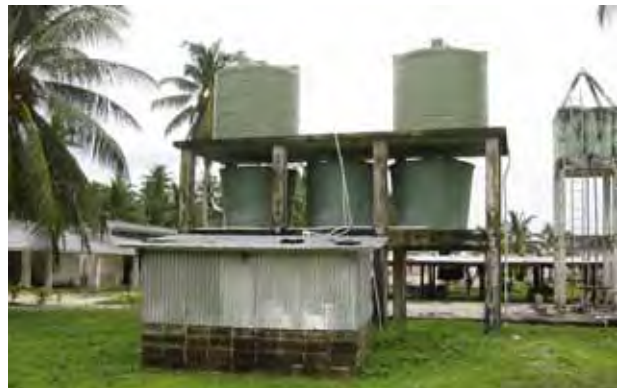
男子寮生活用水用の給水設備。手前小屋内の井戸から取水し、プラスチック貯水槽から重力式で給水する。
