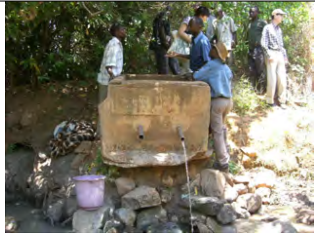
⑩同システム建設以前より住民に利用されてきた湧水取水堰(1970年建設 Tikoliwe/Chikomeni/Mkanda 村)
