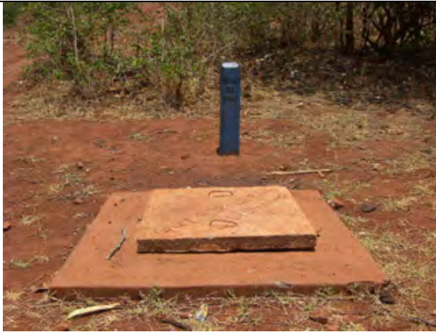
⑨同システム内での配水管分岐点
