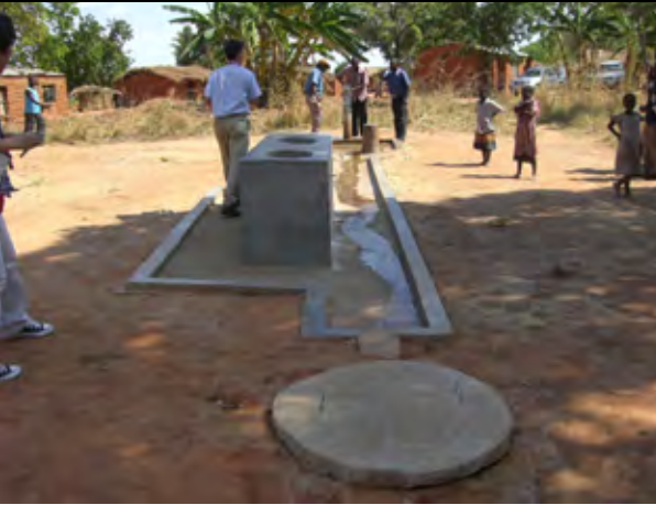
⑰unicef の WASH プログラムにより建設された深井戸給水施設(2009年3月建設 Chichere 村) (撮影日:2010年11月5日)
