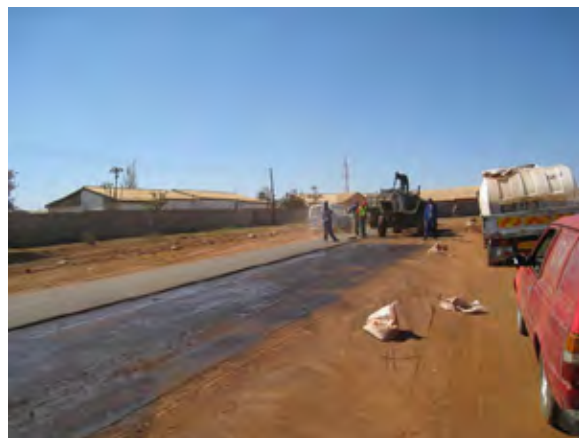
ムシオツヤ道路(南、内環状道延長側) 地元業者により舗装工事完了。
