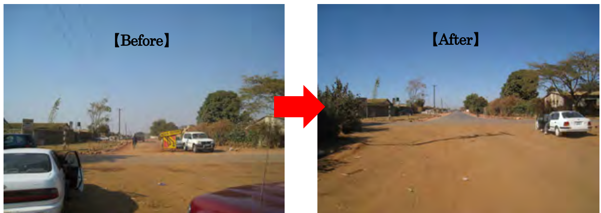
写真 2-2-9 シャンツンプ道路（南側）は調査期間中に地元業者による舗装工事が行われた
