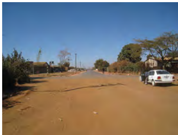
シャンツブ道路(南、内環状道路側) 地元業者により舗装工事完了。
