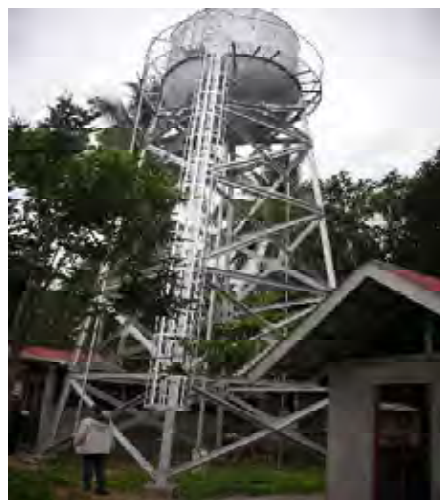
コンポステラバレー州ナブントゥアン町バランガイ・カビディアナンの給水施設
