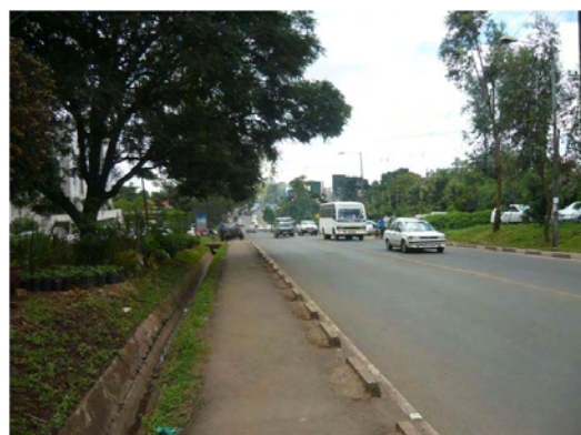
2+500付近(下り線側) 現況道路の縦断勾配が約7%であるため、重量車が徐行運転となり、交通流の妨げとなっている。
