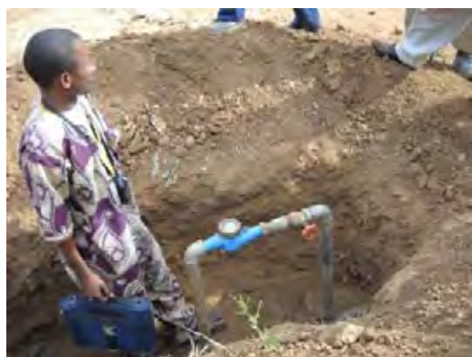
壊れた継ぎ目
