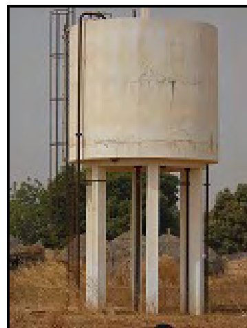
給水塔 カルブロン (直接サイト)
