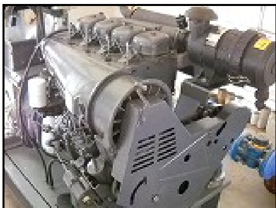
機械室内の発電機 (ジェネレーター) ブスタネ (直接サイト)
