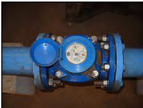
機械室内の流量計 マレメニアニ (直接サイト)
