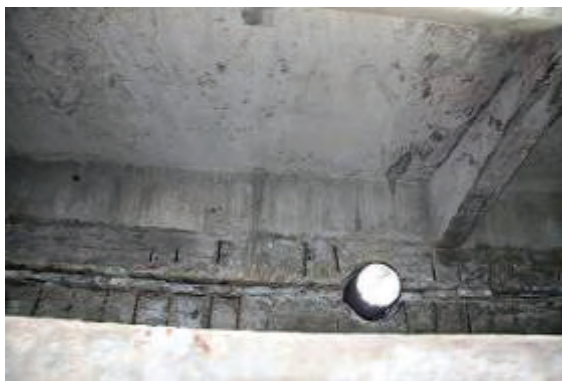
写真5 Old Jetty の裏側 鉄筋が露出
