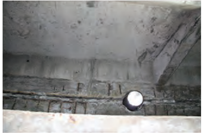
Old Jetty の下側。鉄筋が露出。
