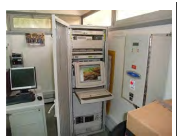
FFWS サーバーシステム
