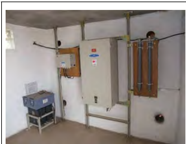
Aoulouss 既設中継局装置
