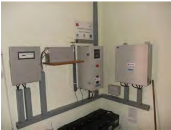
Tazitount 雨量・水位観測装置
