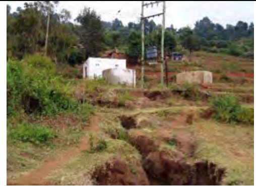
写真-6：商用電力を動力源とした深井戸給水施設。
