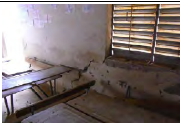
老朽化した校舎の内部 窓や出入口の周りを中心にクラックが入っている。 継続使用が不可能な校舎として判定。(TH15 ティエス州 スッド スタッド小学校)
