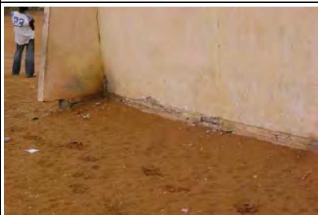
建物の基礎が露出し、鉄筋の爆裂が起こっている。(DK7M ダカール州 リベルテ 6/C中学校)
