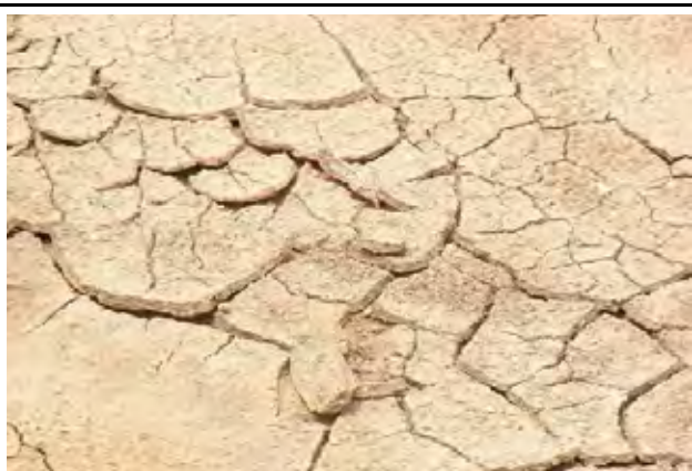
膨張土がある敷地も数箇所確認された。(DK20M ダカール州 キャン マルシャン中学校)
