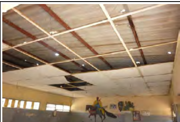
ところどころ天井板がなくなり、屋根にも穴が開いているため雨漏りがする。(DK7M ダカール州 リベルテ 6/C中学校)
