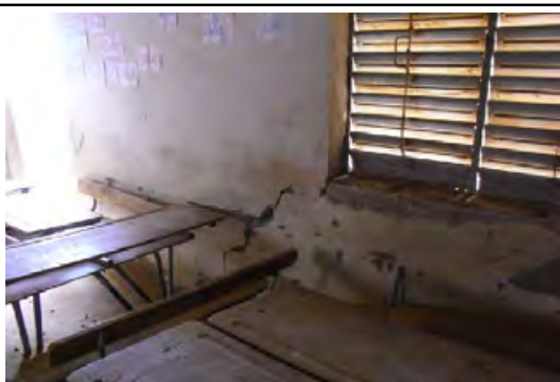
老朽化した校舎の内部 窓や出入口の周りを中心にクラックが入っている。 継続使用が不可能な校舎として判定。(TH15 ティエス州 スッド スタッド小学校)
