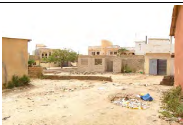
囲い塀が部分的にないため部外者が敷地内に入ってくる。(DK20M ダカール州 キャン マルシャン中学校)
