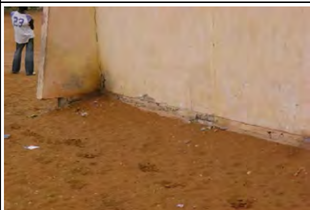
建物の基礎が露出し、鉄筋の爆裂が起こっている。(DK7M ダカール州 リベルテ 6/C中学校)
