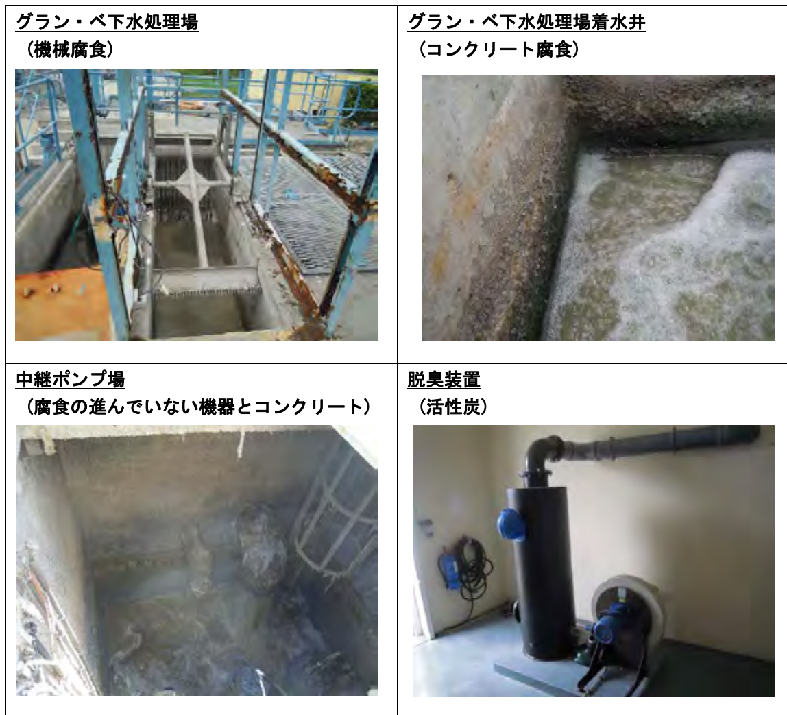
図 3.3-6 硫化水素腐食状況等
