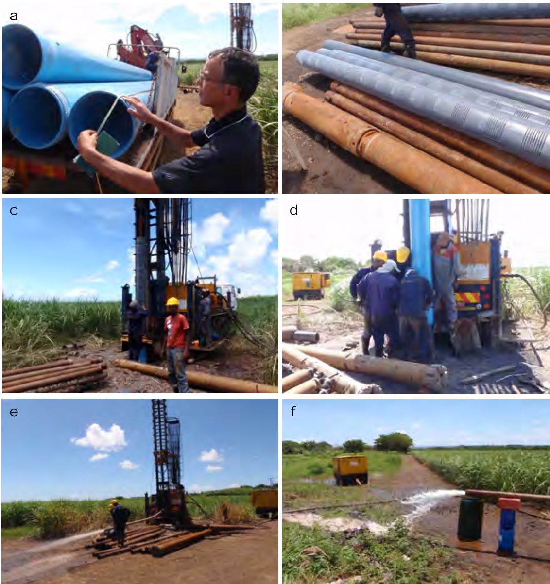
図 4.3-3 (a) 直径 300mm の塩ビ管ケーシング; (b) スリット穴の入った塩ビ管; (c) ポアホールへの塩ビ管の立て込み; (d) 塩ビ管のフィルター材の巻き付け; (e) エアリフトによる孔内洗浄; (f) エアリフトからの流水
