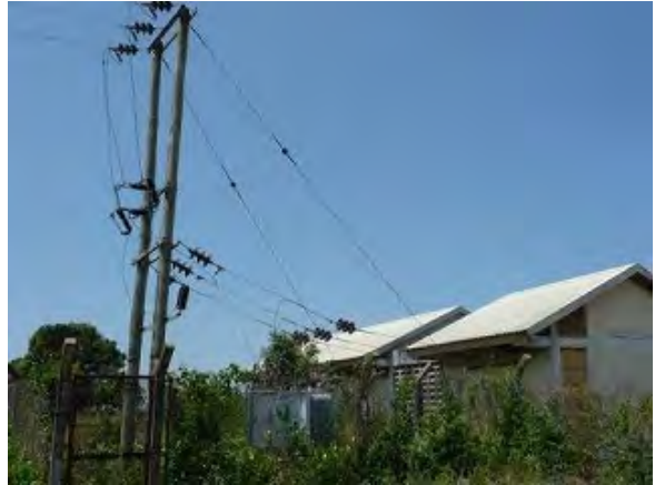
Fumba ルート配電線(空港内の変電所)
