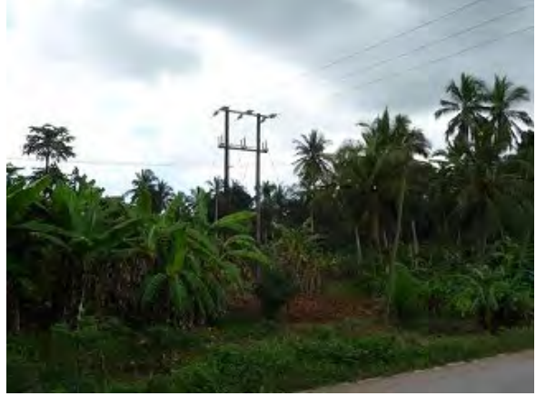
北ルート配電線
