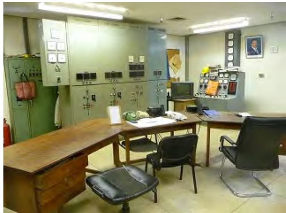
Mtoni 変電所の制御棟内の様子
