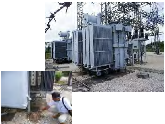
Mtoni 変電所の変電設備(33/11 kV 変圧器)
