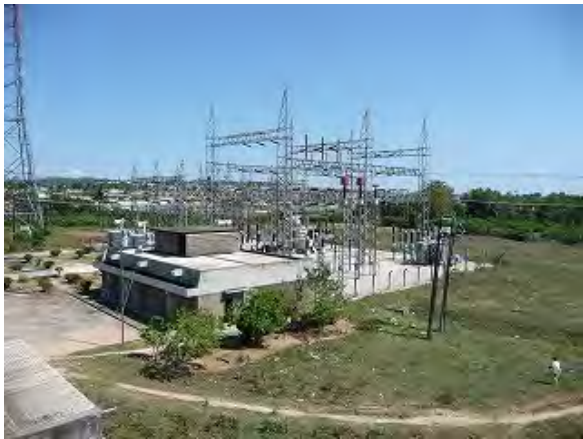
Mtoni 変電所外観
