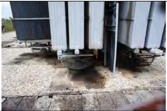
写真 2 ラジエータ漏油箇所
