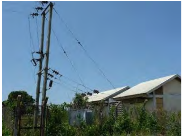
Fumba ルート配電線 (空港内の変電所)
