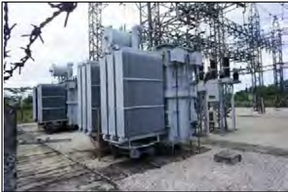
写真 1 33/11 kV 変圧器全景
