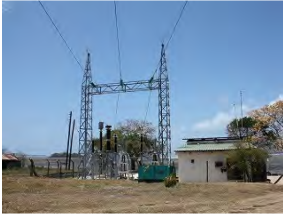
海底ケーブル接合部 (Fumba 揚陸地点)
