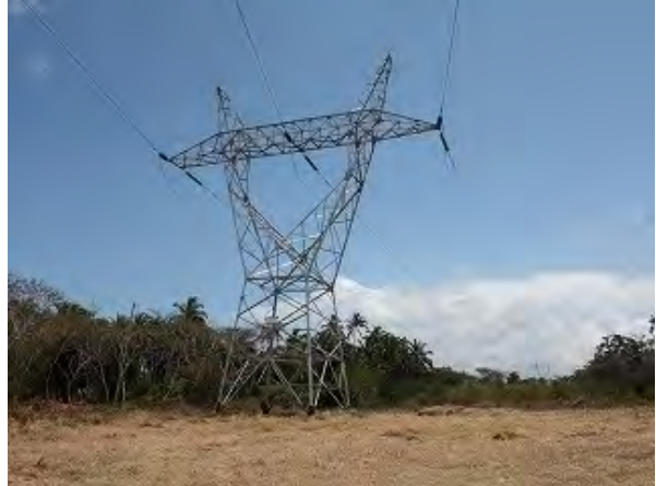
既設 132 kV 送電線
