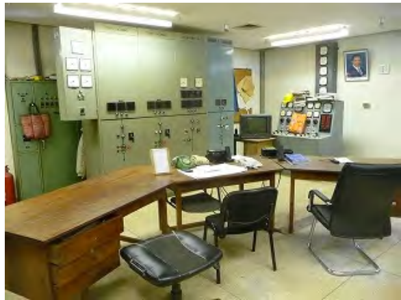
Mtoni 変電所の制御棟内の様子
