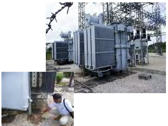
Mtoni 変電所の変電設備 (33/11 kV 変圧器)
