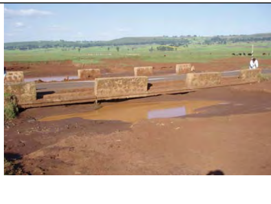
写真-10：桁下空間が埋没しており、雨季に冠水を繰り返す（イエダ川）
