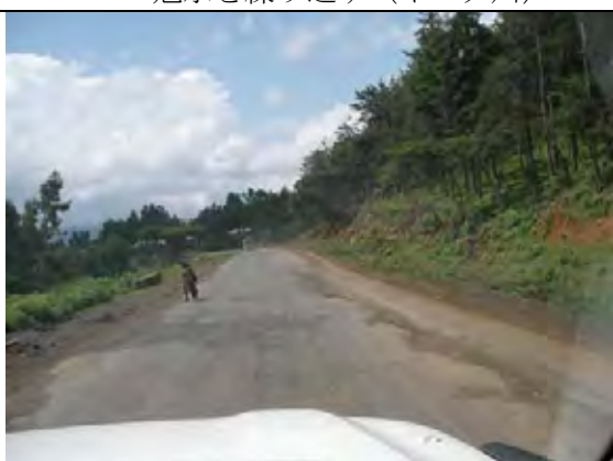
写真-11：舗装の摩耗が進んでいる
