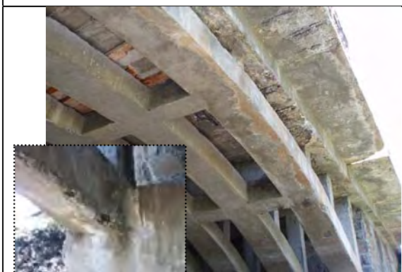
写真-5：コンクリートの劣化、剥離、鉄筋露出、鉄筋腐食、床板破損、防護柵消失、幅員不足（アバアダム橋）
