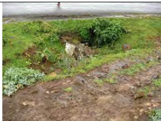
写真-4：損傷した Box カルバート
