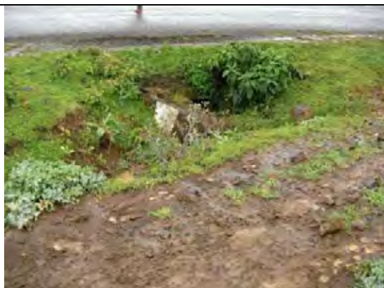
写真－４：損傷した Box カルバート
