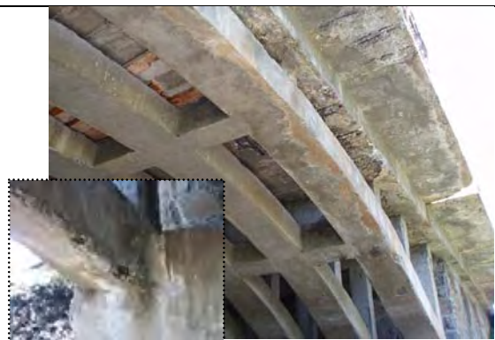
写真－５：コンクリートの劣化、剥離、鉄筋露出、鉄筋腐食、床板破損、防護柵消失、幅員不足（アバアダム橋）
