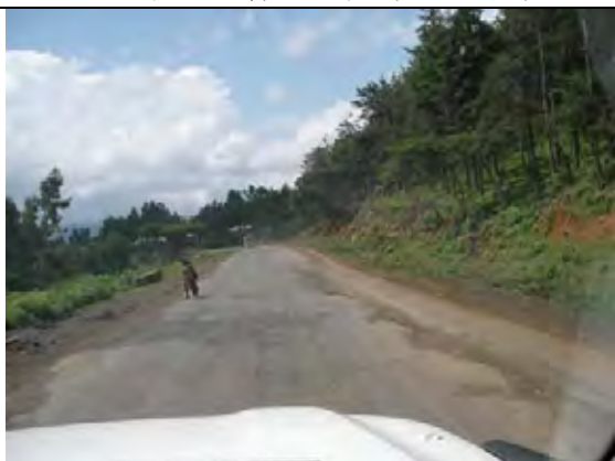
写真－11：舗装の摩耗が進んでいる
