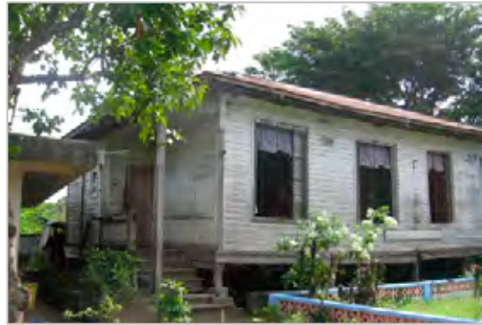
⑩築98年経ち老朽化が著しいにもかかわらず、現在も使用されている家庭科室。
