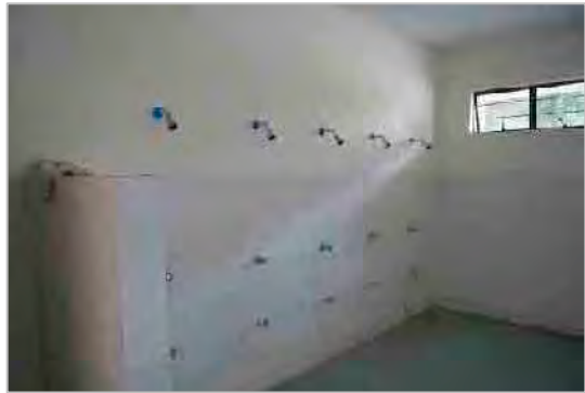
④男女別避難時用のシャワー室。（トラベシア小学校）
