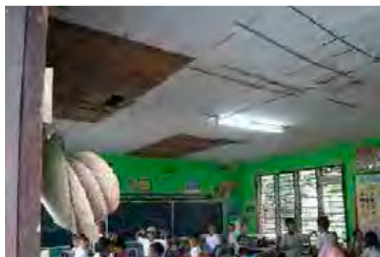
⑧天井が剥がれた教室内部。
