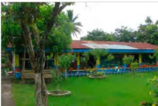
⑥錆が目立ち、一部修繕の痕がある教室の屋根。
