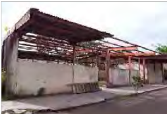
⑪屋根がなく、損傷も激しいため使用できない教室。
