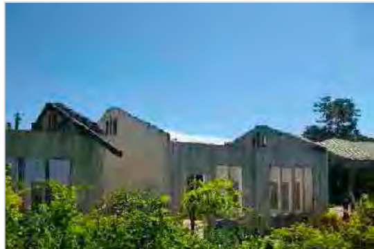
⑭台風により屋根が吹き飛ばされ、使用不可となった教室。
