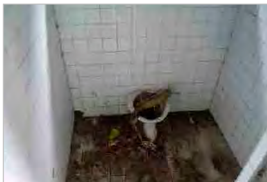
使用不可となっている共有トイレ。
