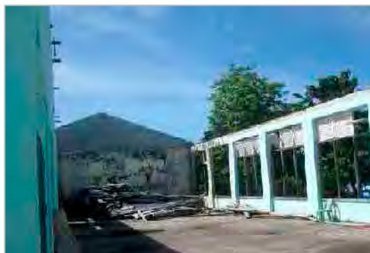
⑱屋根が吹き飛ばされたまま修繕されていない校舎。
