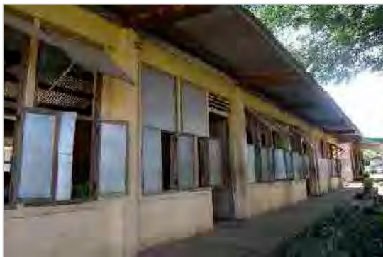
⑯破損し、修復された教室の窓。締め切ると密室になるため暑い。
