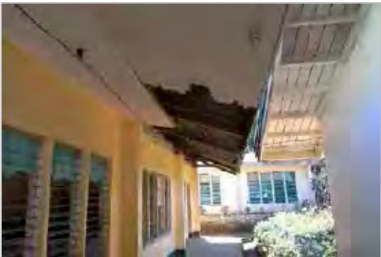
⑮本来は多目的室であるが、教室不足のため就学準備課程の児童が使用している。軒の損傷が激しい。
