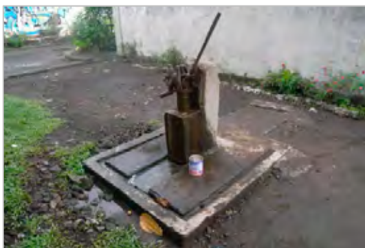
サイト内の既存井戸。
