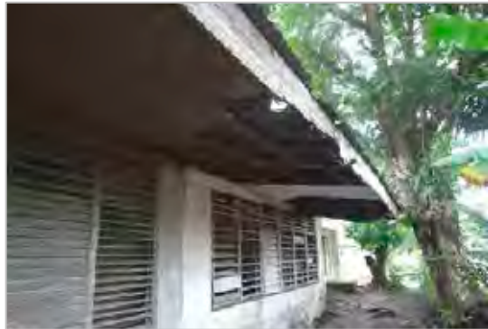
⑫軒の損傷が激しい教室。
