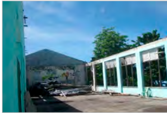
⑱屋根が吹き飛ばされたまま修繕されていない校舎。
