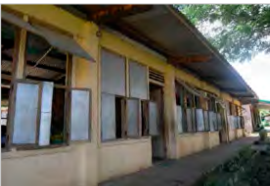
⑯破損し、修復された教室の窓。締め切ると密室になるため暑い。
