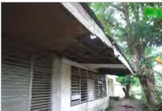
⑫軒の損傷が激しい教室。
