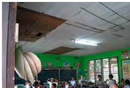
⑧天井が剥がれた教室内部。
