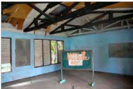
天井が剥がれ、窓の一部が壊れている教室。
