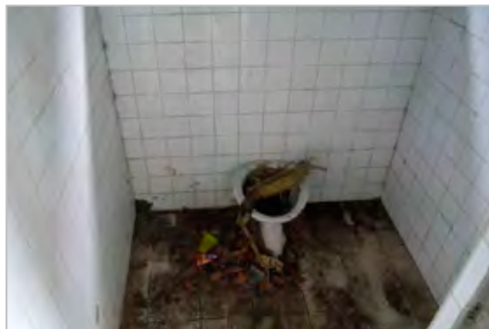
使用不可となっている共有トイレ。
