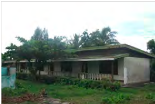
建設予定地と、築60年以上経ち老朽化が激しい校舎。
