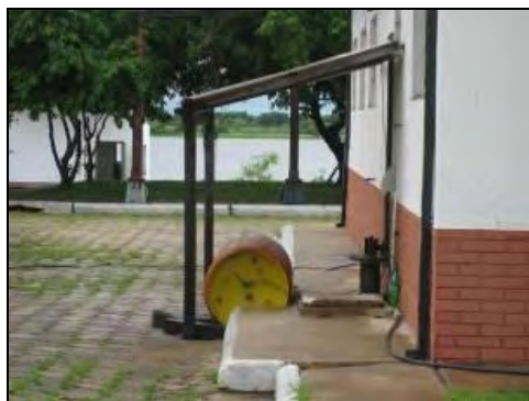
屋外に設置され使用される塩素ボンベ ピラール市浄水場
