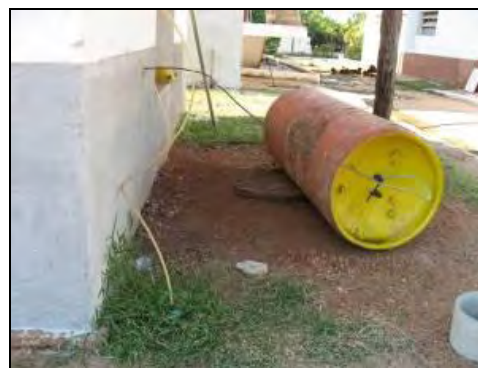
屋外に設置され使用される塩素ボンベ コンセプション市浄水場
