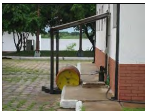
屋外に設置され使用される塩素ボンベ ピラール市浄水場
