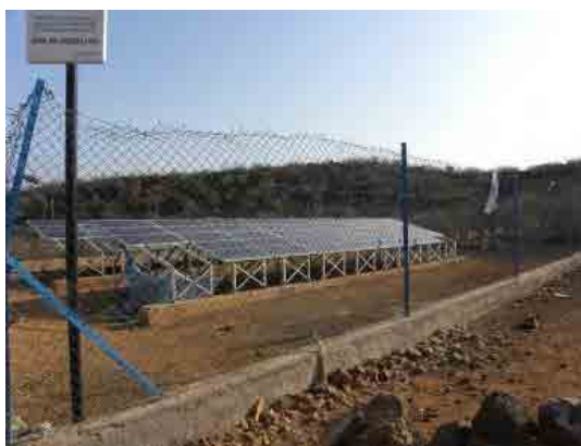
写真-10：Saudi Arabia プロジェクトで2006年に建設された給水施設用ソーラー発電設備 (Arta 県 Chabellei 村)
