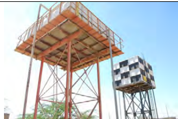
写真-2.13.13 給水タンク (50m 3 、54m 3 )
