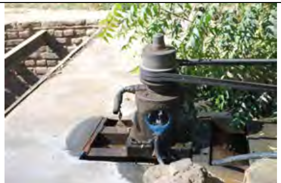
写真-2.13.12 エンジンポンプ
