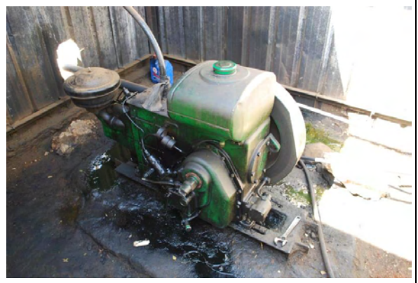
写真-2.1.2 ポンプ用エンジン
