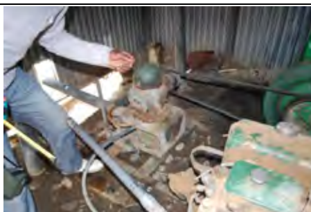
写真-2.21.6 エンジンポンプ
