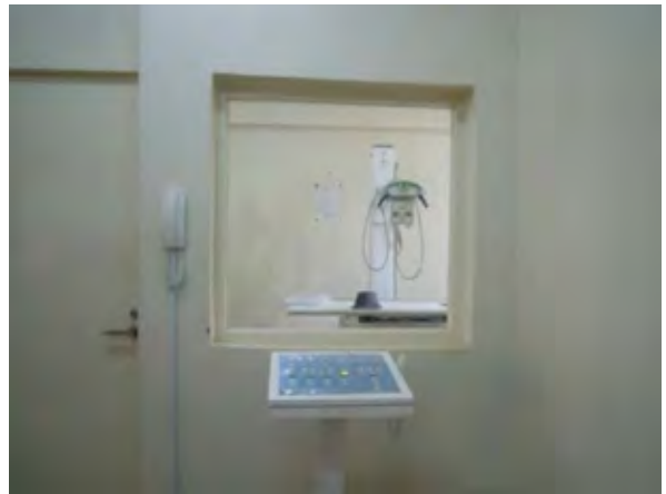
マサフ県病院のレントゲン室
