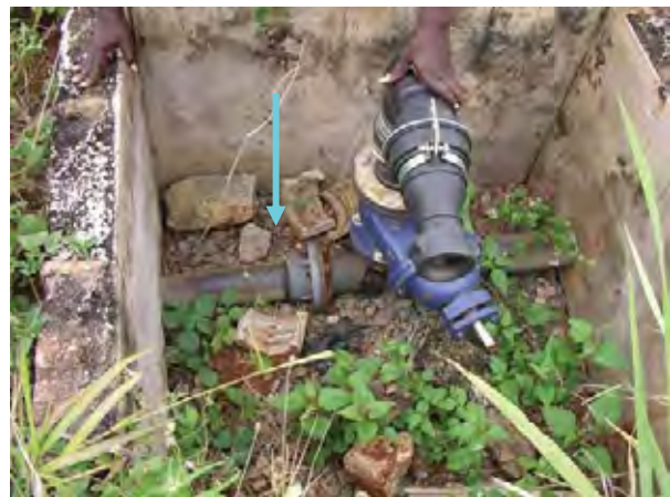
試験運転の際、水色の矢印の継手からの漏水が著しく、使用停止している給水バルブ。全域で継手問題が発生しており、施設の利用ができない状態にある。
