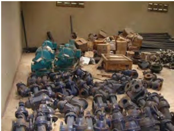
搬入したポンプの仕様の間違いのため、設置されずに倉庫に眠るポンプおよび部品。
