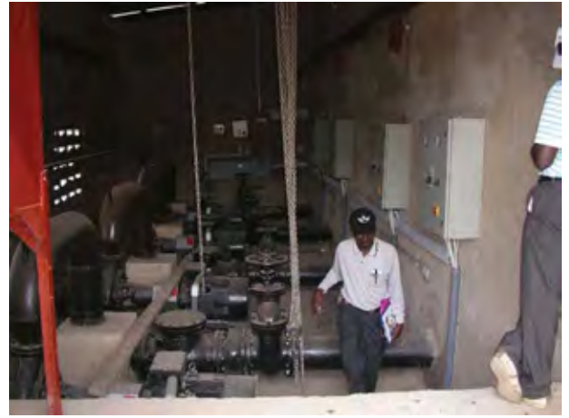
4基のポンプが設置されている。試験運転は未実施
