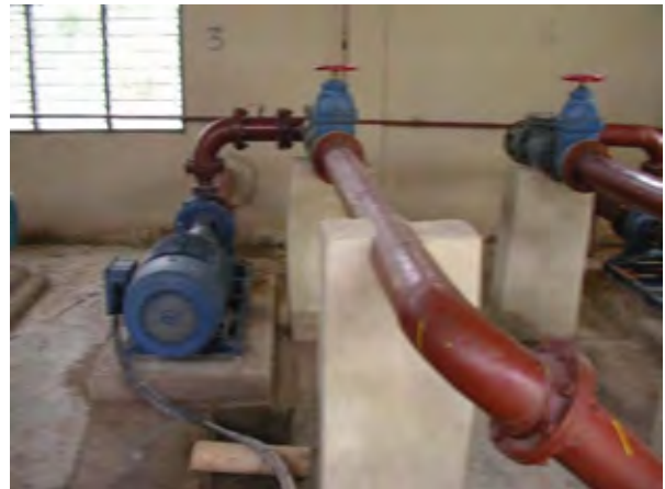
設置されているポンプ： 業者がポンプの仕様を間違え搬入したため、2種類のポンプが設置されている。
