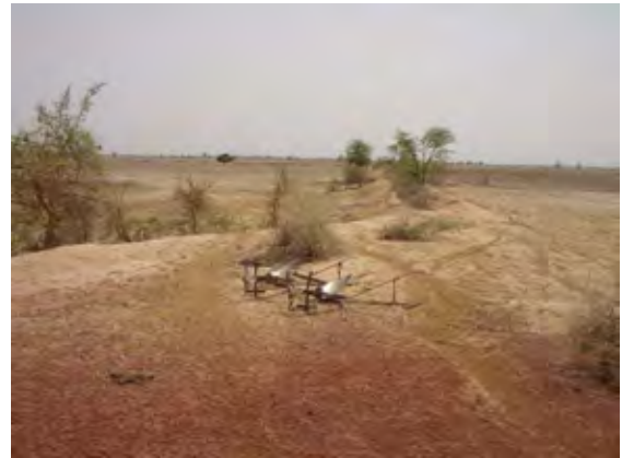
Bani 川から延びる旧幹線水路 水路断面は砂で埋もれ所々で低木が生えている
