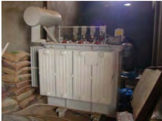
右上写真ポンプの裏手に見える配電室の中
