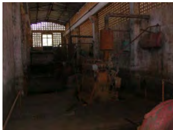
ポンプ場内、全面的改修が必要
