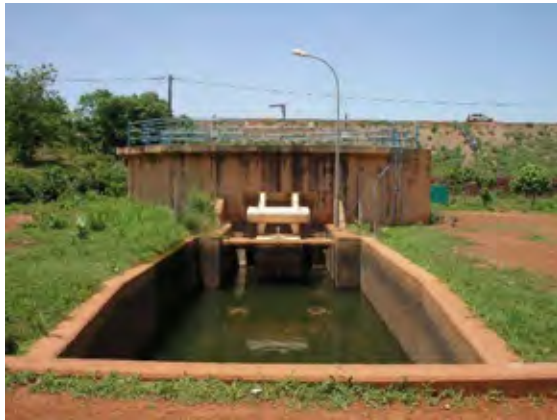
セレンゲダムからの取水施設
