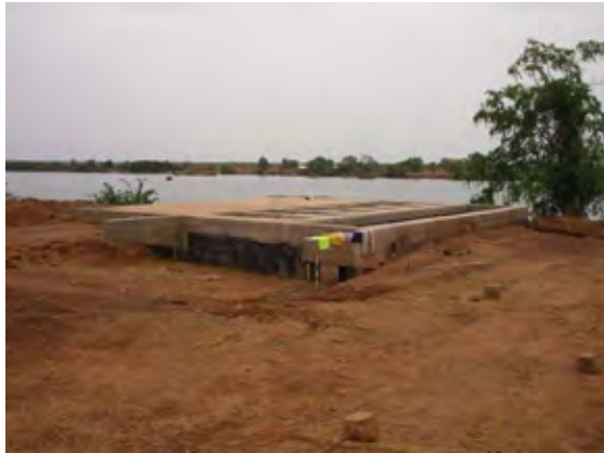
未完成のままのポンプ場建屋
