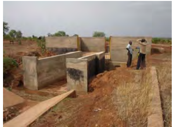
幹線水路接続部と配水槽
