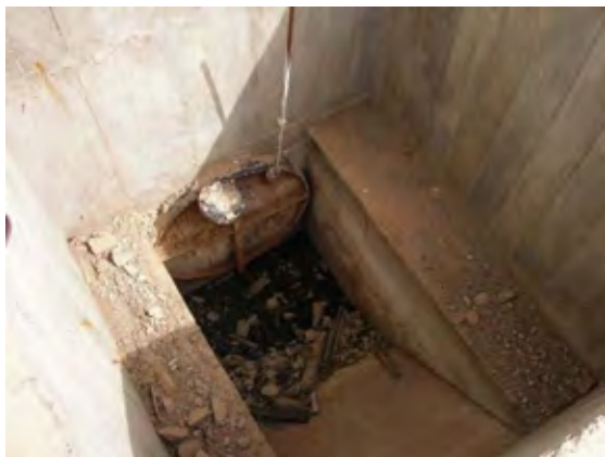
配水槽内、パイプラインの出口
