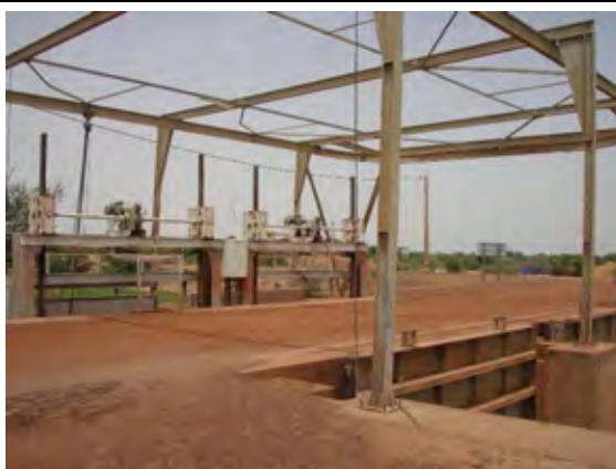
Poin A 地点、ワゴイ幹線水路取水工 (世銀資金)
