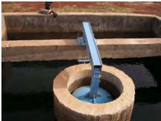
パイプラインでの送水、分水工のポート弁
