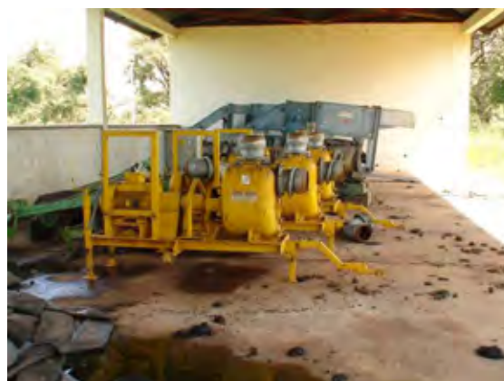
使われずに錆付いているポンプ
