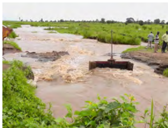
下流の幹線分水工が流出してしまっている。
