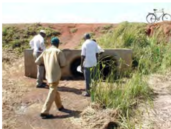
イテック・ダムの放流工
