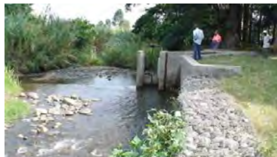
ムブク頭首工からの取水工 (パイプライン)
