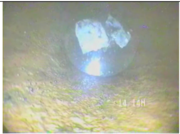
Photo du tubage à proximité du niveau d'eau statique FASS NDIBELANE 56,56 m
