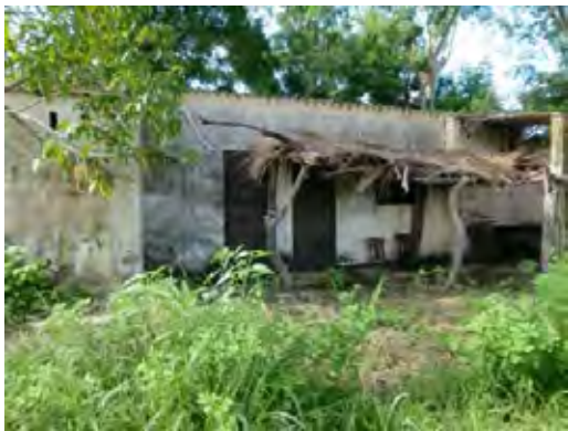
写真-9 管理人室 他ドナーにより建設されたが、施工品質が悪く、 壁のひび割れ、雨水の浸入により老朽化が著しい (ダル・サラム・シンⅡ)
