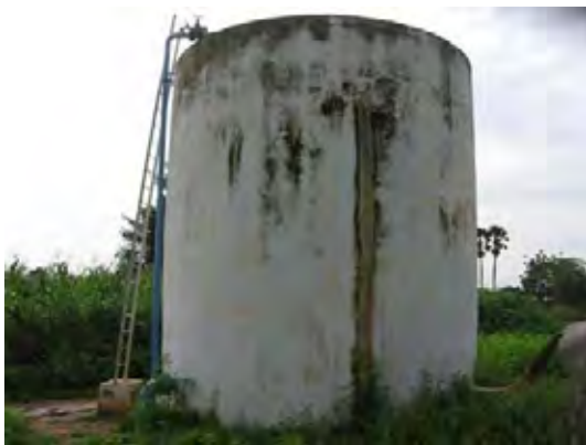
写真-3 地上型水槽 漏水が多く、補修が必要 (グンバイエル)
