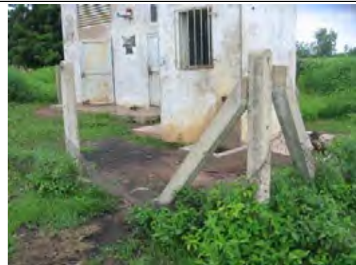
写真-6 機械室柵 柵が家畜により壊された為、補修が必要 (シンチュウ・マレム)
