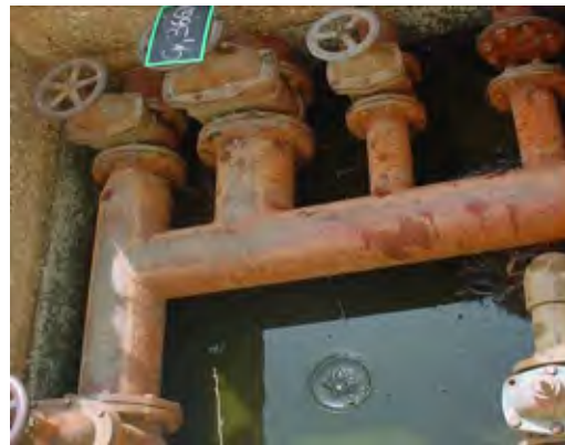
写真-4 バルブボックス バルブから漏水しているため交換する (グディリー)
