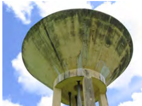
写真-2 高架水槽 漏水が多く補修が必要 (ミシラー)
