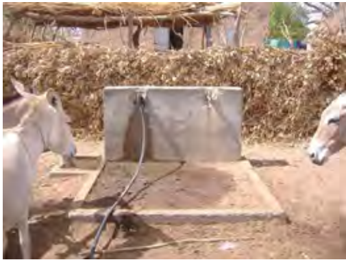
写真-7 公共水栓 給水栓から漏水している為、給水栓の交換が必要 (ムバイエン・チャスデ)
