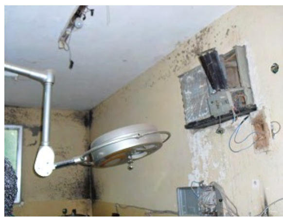
シンジャ教育病院手術室内の内部 エアコンも天井の電灯も配線、部品が剥き出し。
