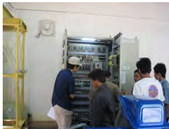
同・制御盤点検
