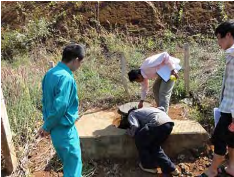
パトロール状況 (オモレン発電所) 水圧鉄管のマンホール点検
