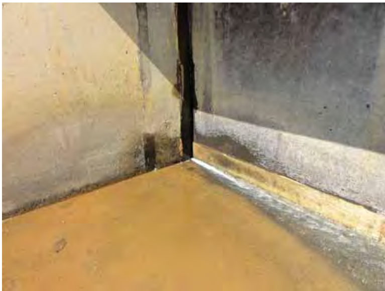
パトロール指導 (オモレン発電所) 排砂ゲートからの漏水
