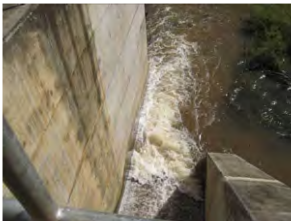
オロミス水力発電所ダム排砂ゲート
