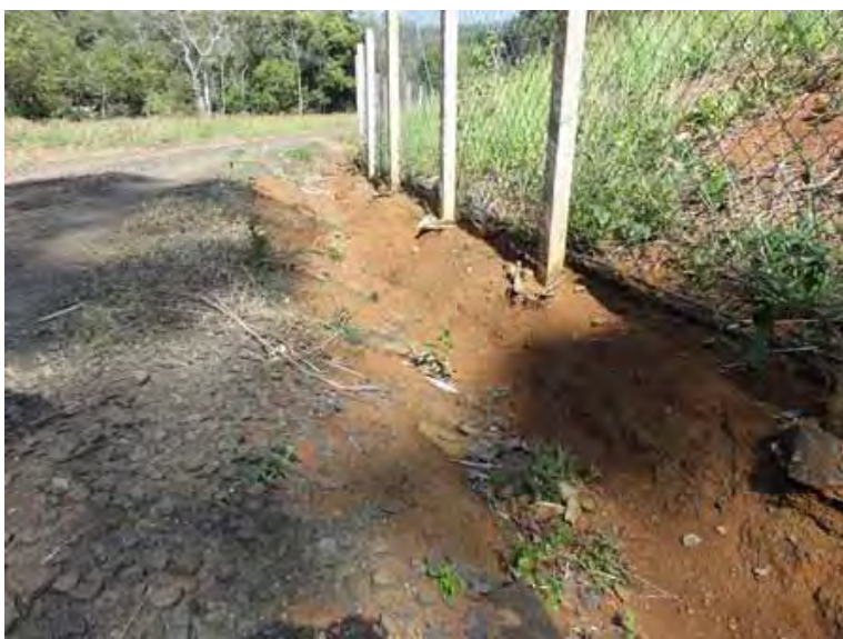
パトロール指導 (オモレン発電所) アクセスパ沿いの落石防護 フェンス支基礎部分
