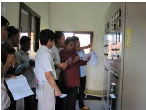
制御盤での現場研修
