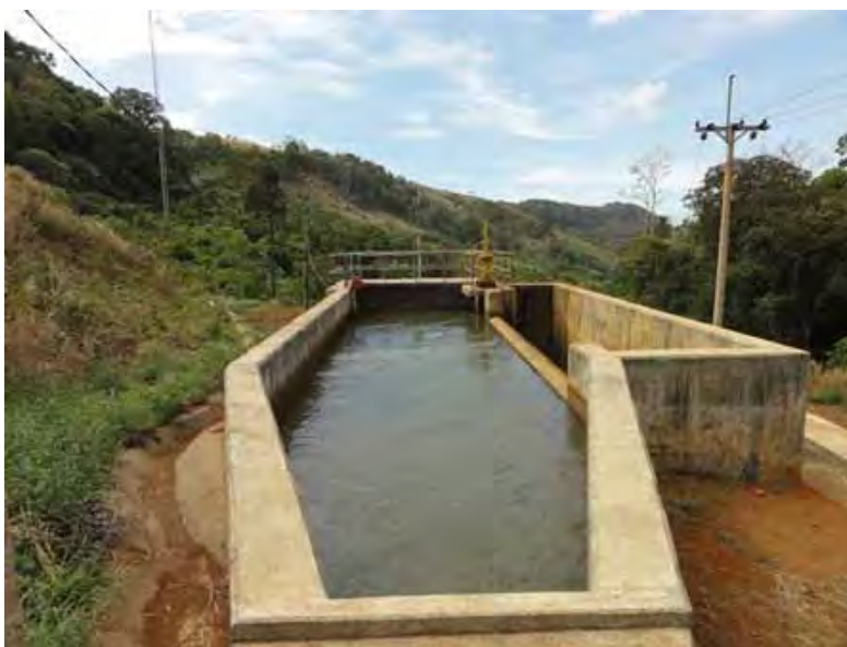
オロミス発電所 水槽の現況。 余水吐への越流はなかった。 撮影時の発電電力 140kW。
