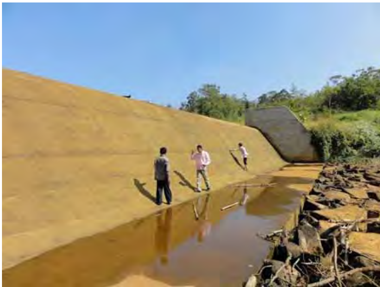
パトロール指導 (オモレン発電所) 取水堰ジョイント部分の滲み
