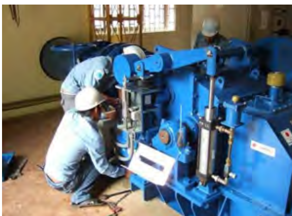
オロミス水力発電所・サーボモータ点検
