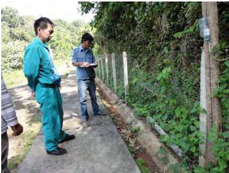
パトロール状況 (オロミス発電所) 落石防護フェンス支柱の倒壊
