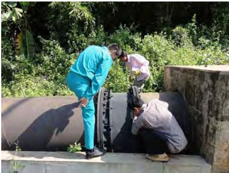
パトロール状況 (オモレン発電所) 水圧鉄管のジョイント部点検
