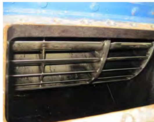
オロミス水車ランナー内部
