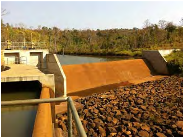
オモレン取水堰付近の状況
