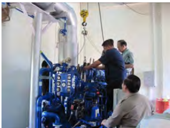
DG 分解定期点検（4,000－5,000 時間）
