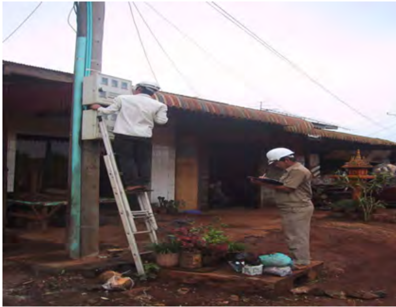
電力量メーターの検針状況
