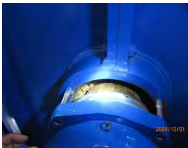
水車軸受けの泥水による パッキン部の汚れ(補修前)
