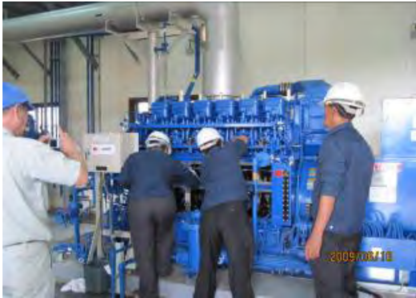
ディーゼル定期点検状況 (エンジン本体分解点検)
