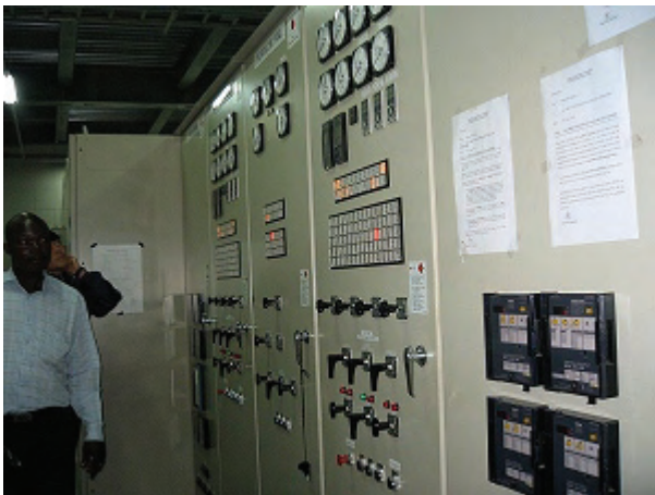
キングトム発電所：制御盤
