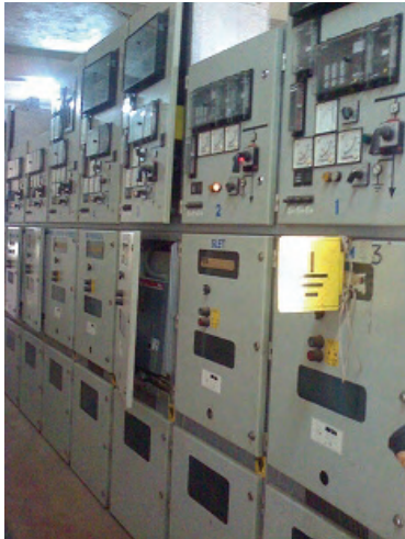
7. ファルコンブリッジ変電所: 高圧フィーダー盤の使用状況
