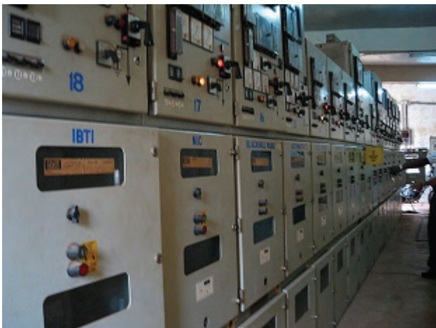
ファルコンブリッジ変電所：変電盤
