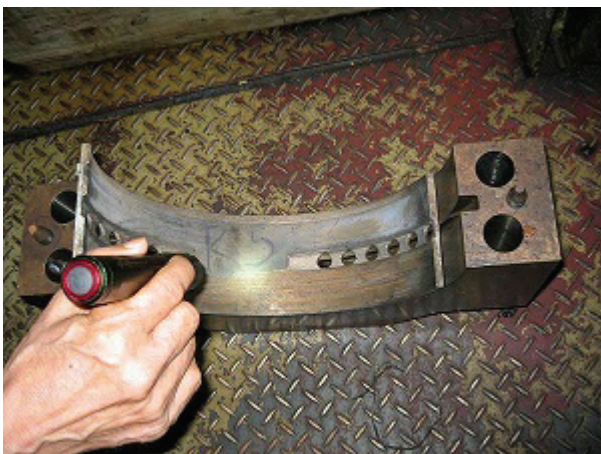
キングトム発電所：6号基エンジン故障部品
