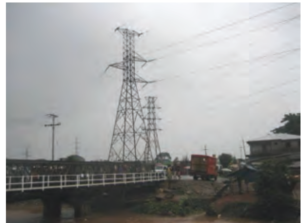
12. フリータウン変電所につながる架空送電群 (右からウィルバーフォース変電所行きの33kV線、ブンブナ水力発電所からの161kV線、左端はコンゴクロス変電所行きの11kV線)
