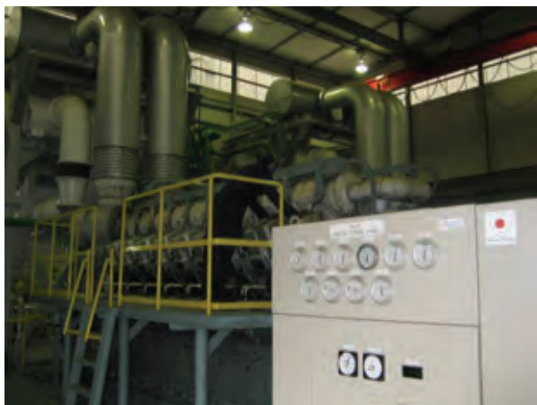
1. 運転中の新潟 8 号発電機（後方は 7 号発電機）
