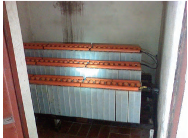
8. ファルコンブリッジ変電所: バッテリー盤の状況
