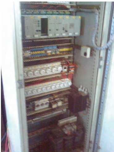
11. ファルコンブリッジ変電所: 充電器盤の状況
