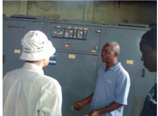
10. キングトム発電所: 高圧盤の状況
