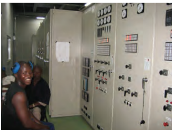
3. 新型発電機運転制御室の状況
