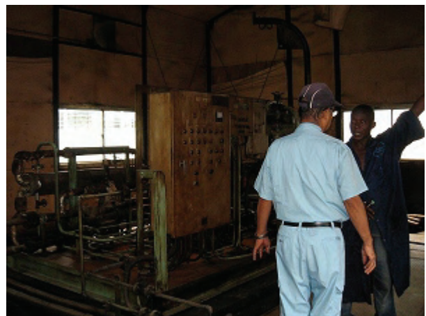
キングトム発電所：6号基ろ過施設
