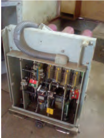
9. ファルコンブリッジ変電所: 遮断機 (盤から引き出した状態)
