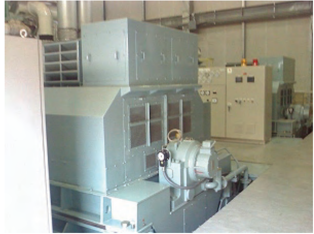
キングトム発電所：7号基、8号基（Niigata 製）
