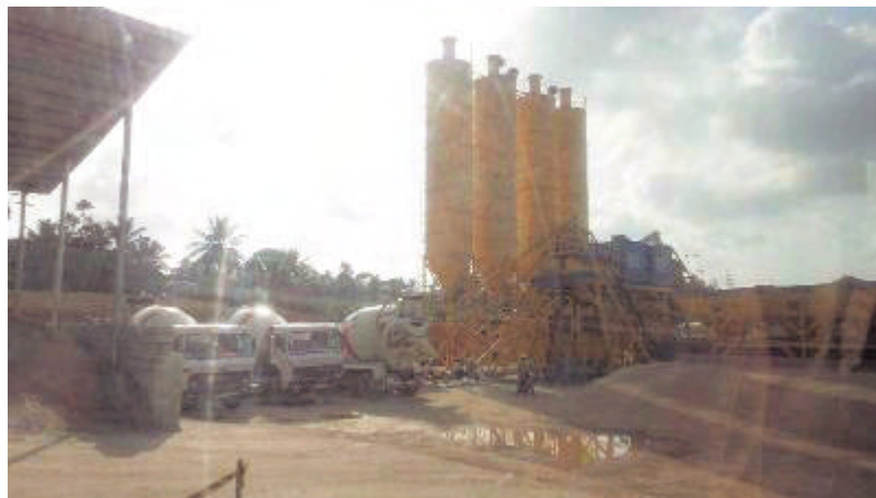
写真 23 プラント状況
