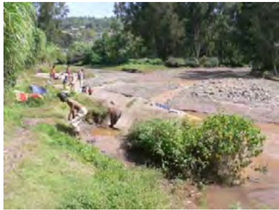
ヒルナ(Hirna、OJT候補地区)、崩壊した頭首工
