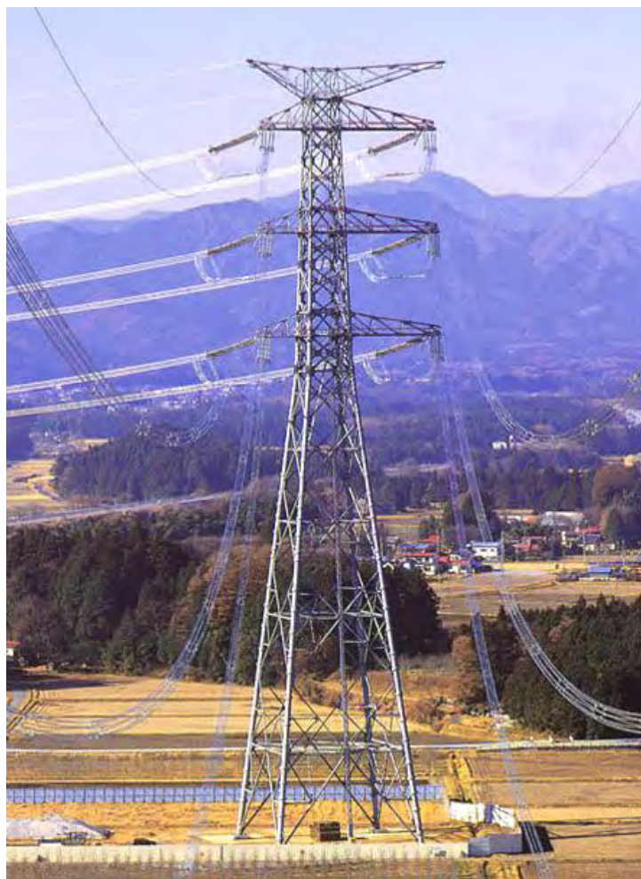
図 2.4.9.1 東京電力(株) 北栃木幹線 1,000kV(UHV)鋼管鉄塔
