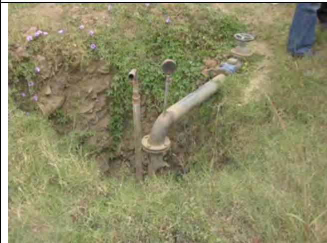
揚水井(もう一方の注入井での注入量が 2000m 3 に達したら、役割を交代してこちらの井戸が注入井となる)
