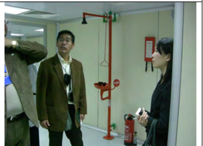
薬品事故応急対策用のシャワーとアイシャワー設備
