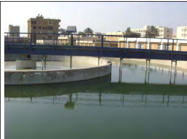
上向流式円形沈殿池
