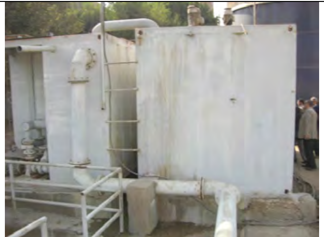
硫酸アルミニウム混和槽(右)と沈殿槽(左)
