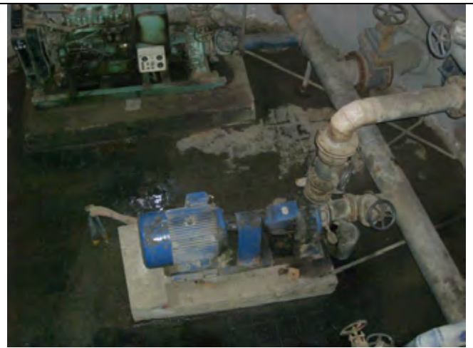
井戸ステーションの自吸型ポンプ
