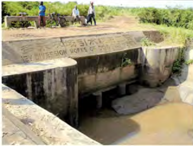
Doho Rice Scheme の灌漑用水取水口。堆砂で埋まりかけている。
