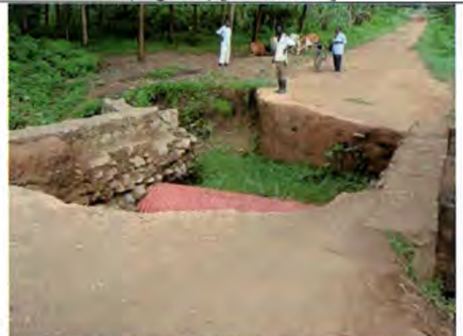
大雨による洗掘で、簡易橋の管が露出。 (Mbale 県) [2009 年 6 月]
