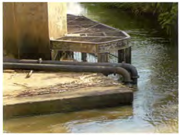
Manafwa 川にある Mbale Municipality 用の給水システムの取水口
