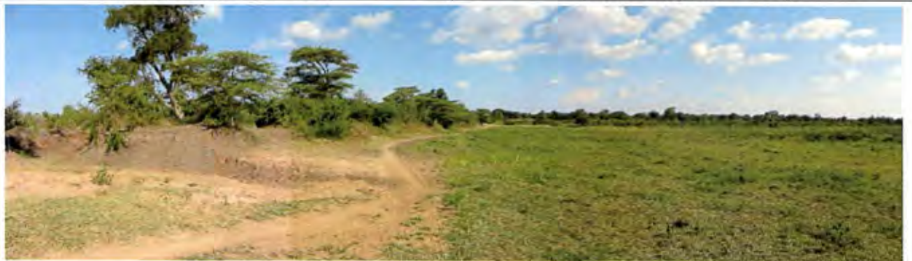
Valley Dam。写真右が上流側、左側がダムの堤体であるが、堤体の端が決壊したために、その貯水能力を失っている。
