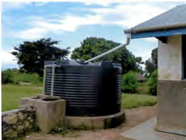
雨水貯留タンク (Soroti 県) [2009 年 11 月]
