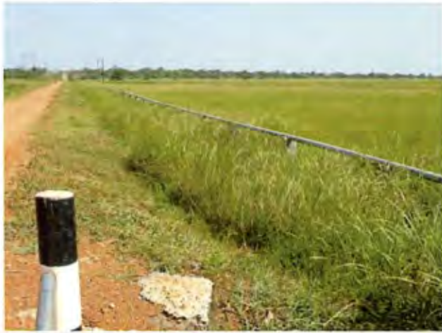
Soroti の給水システムの送水パイプ。Amuria や Kaberamaido にも給水している。
