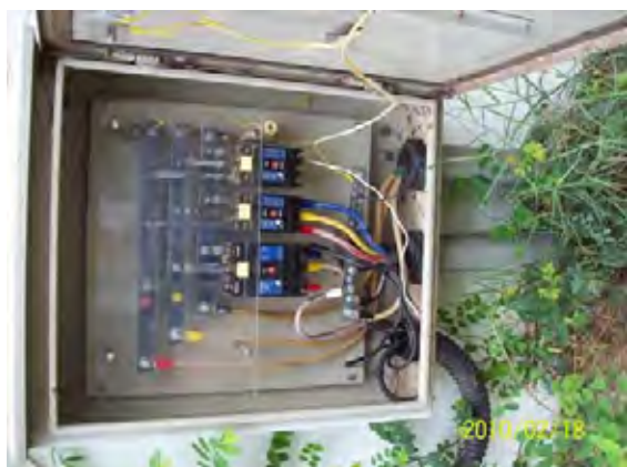
LAA 事務所壁面の分電盤状況 今回発電された電力は最終的にこの LAA 事務所の分電盤に接続する。
