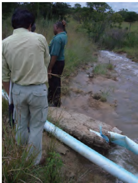
写真2：損壊した取水口付近の導水パイプ むき出しのプラスチックパイプがダム下流の川を横切るように配置されていたため、増水すると容易に折れたことが想像できる。
