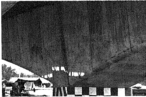
ภาพ 3.3.5: รอยแตกของสะพานพระราม 5 (คานหลักด้านข้าง)
