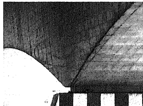
ภาพ 3.3.11: รอยแตกของสะพานพระราม 7 (คานหลักด้านข้าง)
