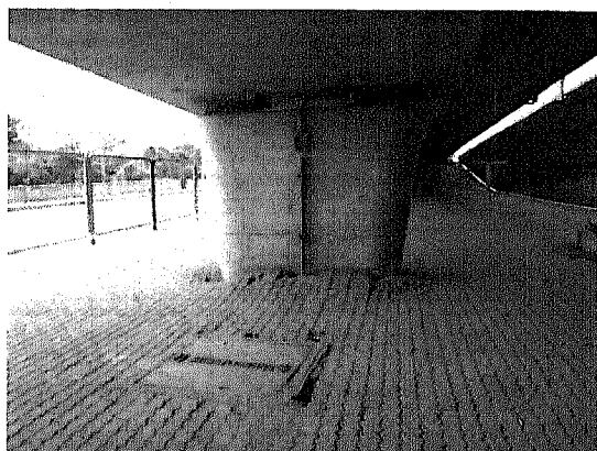
図3.3.8: Rama5橋周辺地盤の沈下 (トンブリ側)
