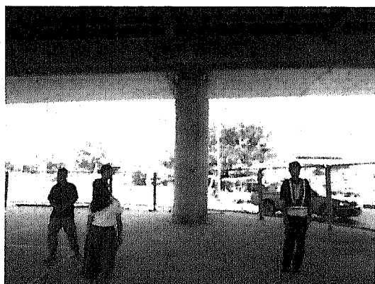
図3.3.7: Rama5橋橋脚の傾斜 (トンブリ側)
