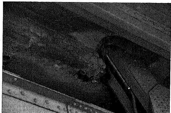
図3.3.32: Krung Thep橋剥離（床版）
