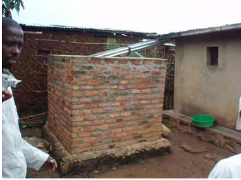
写真 9 : レンガ方形受水槽
