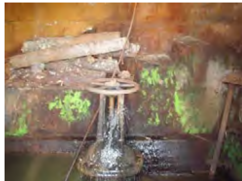
写真3：ゲート操作バルブ
