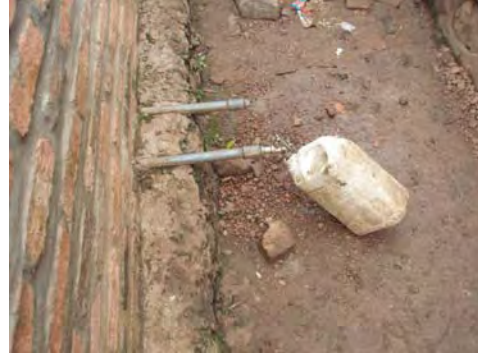
写真 10 : レンガ方形受水槽部分
