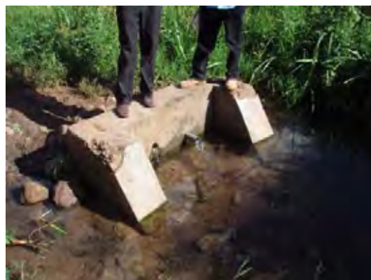
写真 2：ダム 21 計画地直下流湧水施設
