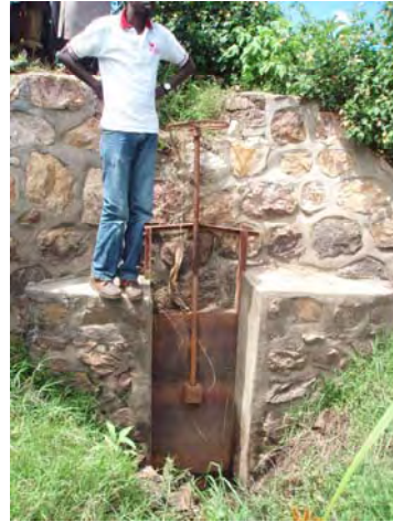
写真8：ため池2取水ゲート
