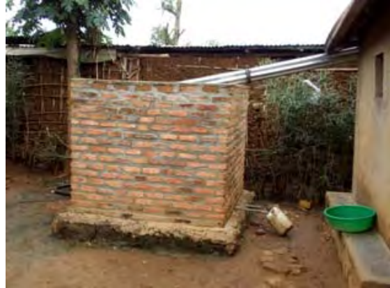
写真2 ：ブゲセラ開発調査のクイック・プロジェクトにて導入された雨水貯留システム
